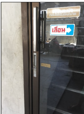
ภาพที่ 3.15 กุญแจ บริเวณทางขึ้นอาคารอพาร์ทเมนต์
